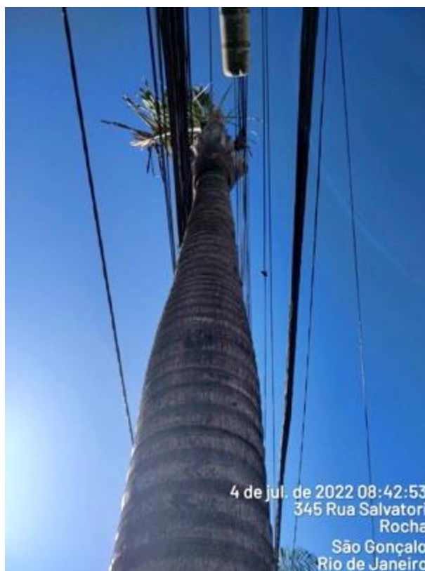
Figura 66 - Árvore ou fiação em local inadequado.
