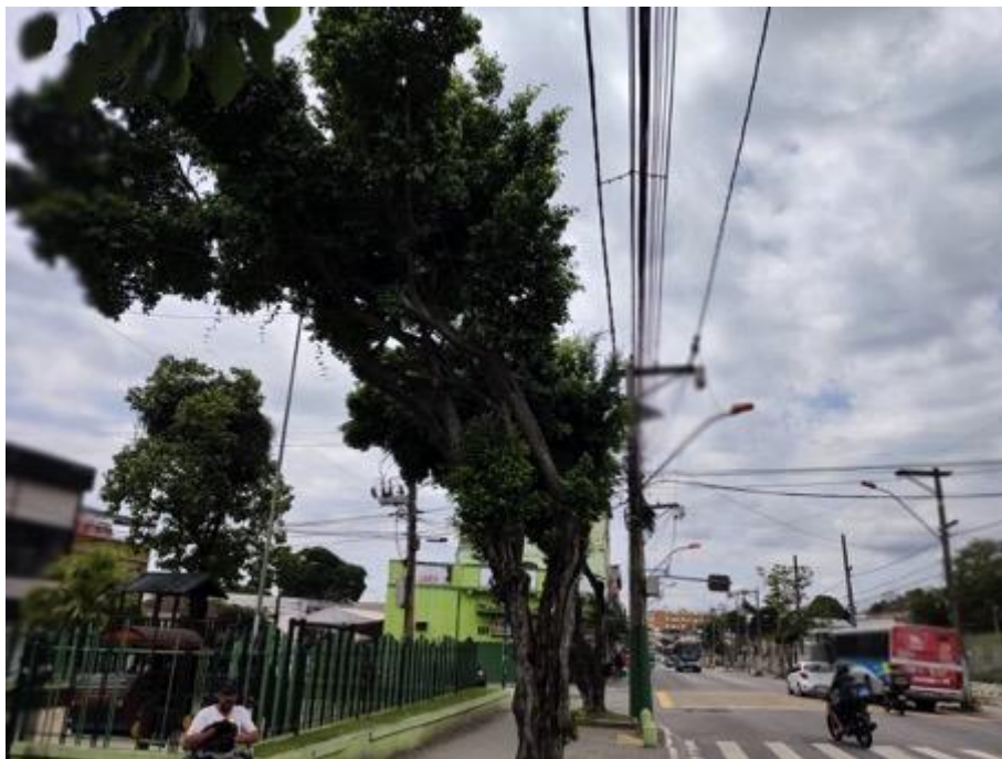
Figura 42 - Árvore de grande porte ( Ficus benjamina ) plantado abaixo de rede de média tensão. As podas sucessivas na árvore, sem o equilíbrio da copa podem gerar o tombamento e eventual queda da árvore.
