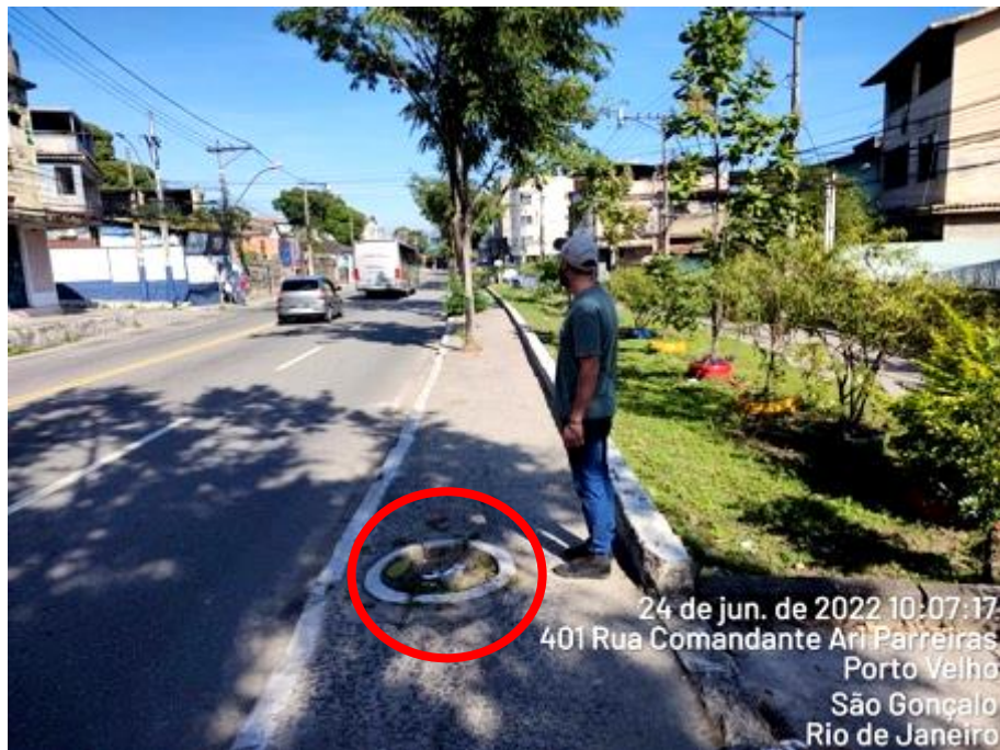
Figura 16 - Gola de plantio em situação inadequada
