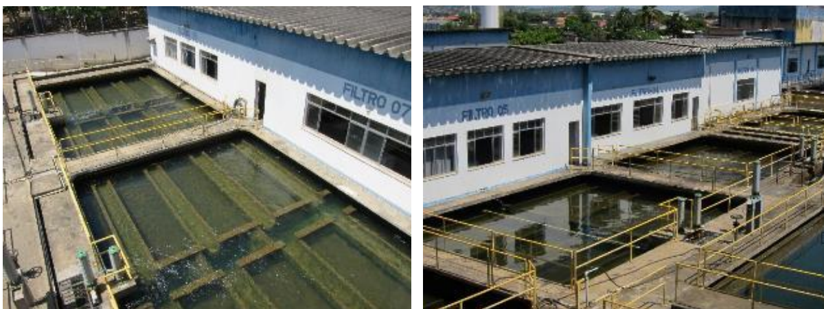
Figura 31 – Tanques do sistema de filtragem da ETA (vista 1 e vista 2)
