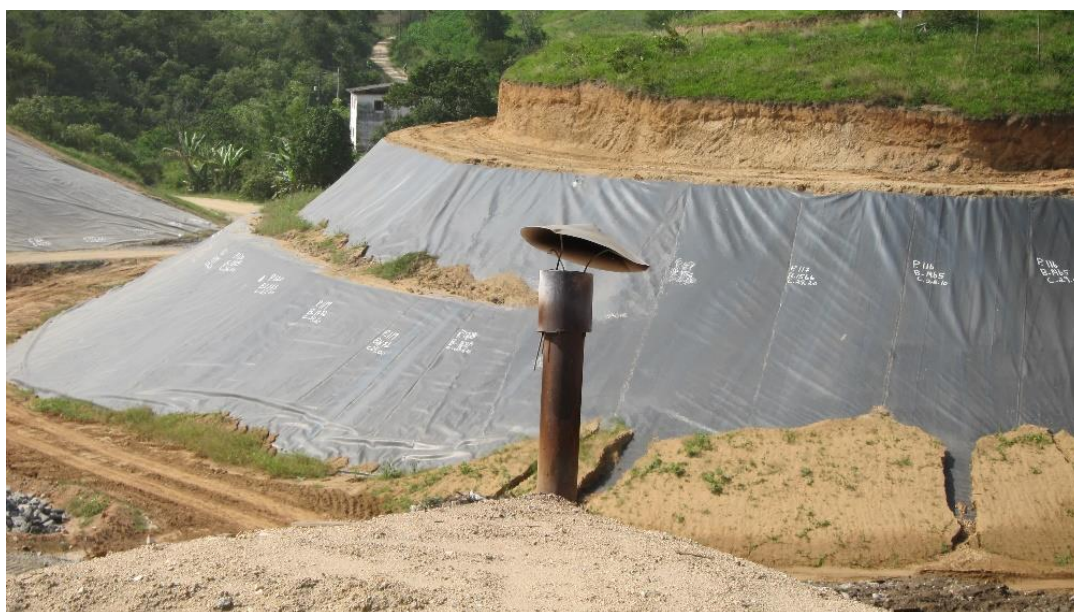
Figura 70 – Detalhe do queimador de gás.
