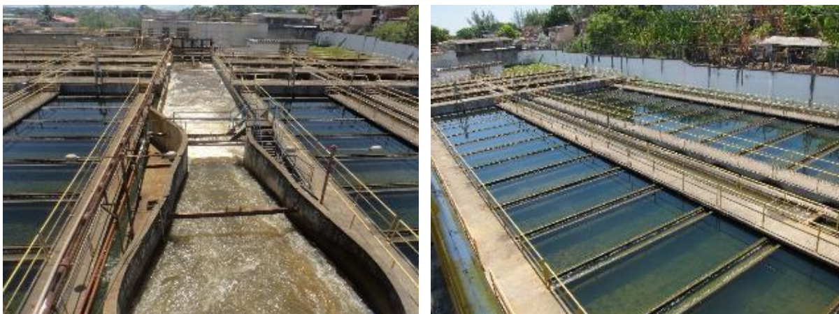
Figura 30 – Tanques sistema de decantação das ETAs (vista 1 e vista 2)
