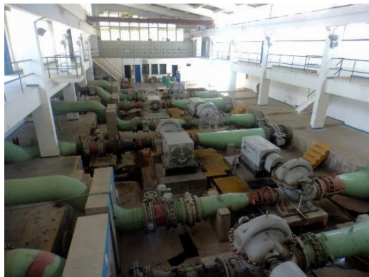
Figura 33 – Elevatória da ETA Laranjal.
